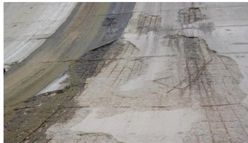
شکل ۱- تخریب سطح سرریز سد میناب
